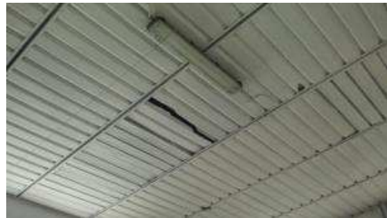
Foto 31: particolare crepe e fratture, anno 2016
