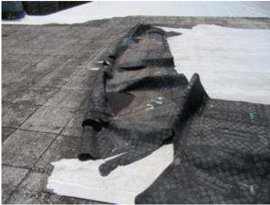
Foto 52: particolare della parte danneggiata
