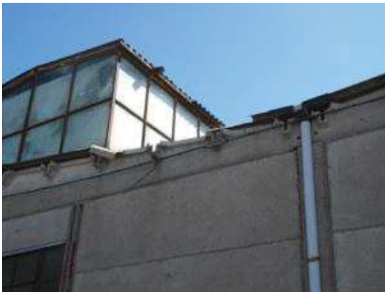
Foto 26: particolare danneggiamenti lato Ovest, anno 2016
