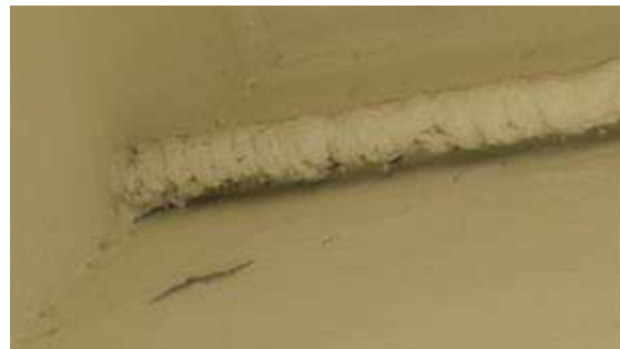
Foto 43: tubazione n.2 presso vecchi bagni
