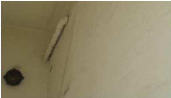
Foto 42: tubazione n.2 presso vecchi bagni
