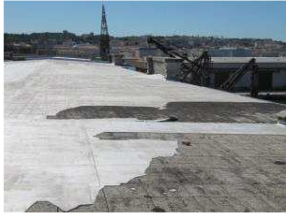
Foto 51: veduta dell'area danneggiata
