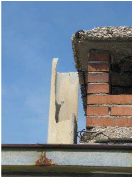
Foto 12: particolare del camino, danneggiamenti
