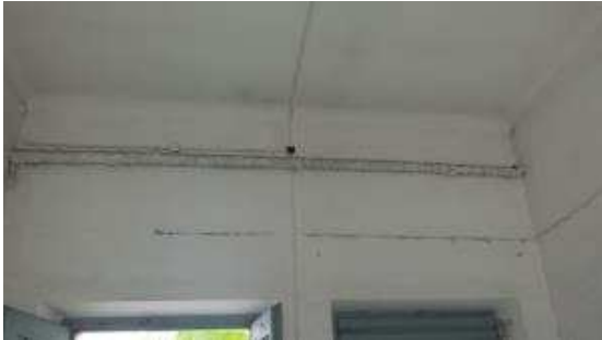
Foto 40: tubazione n.1 presso vecchi bagni, anno 2016
