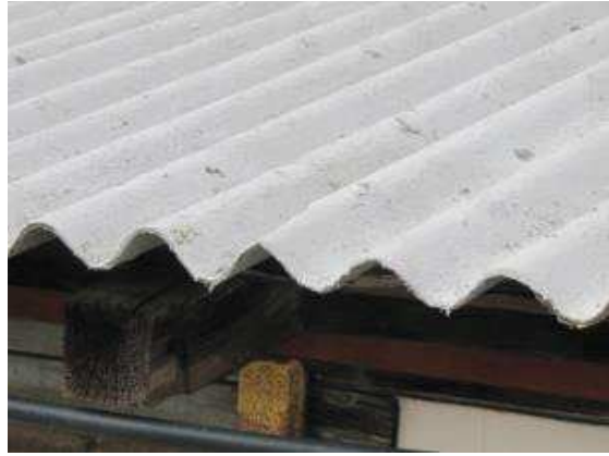
Foto 4: particolare dopo l'incapsulamento, anno 2014
