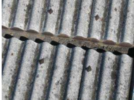
Foto 25: particolare, sedimento in gronda, anno 2016
