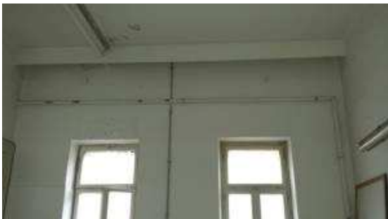
Foto 44: tubazione presso locali in concessione a TTP
