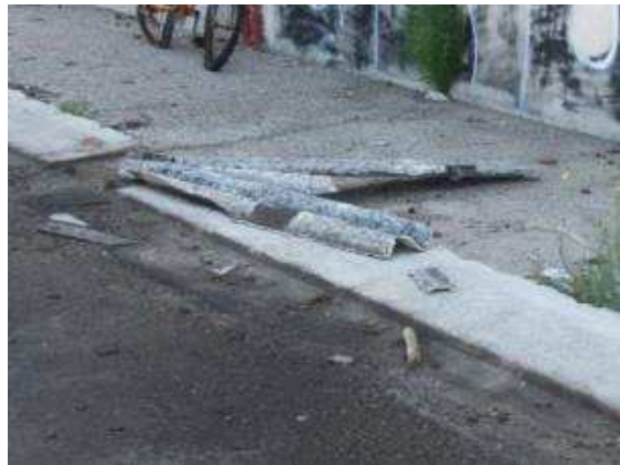
Foto 27: particolare delle lastre cadute a terra, anno 2016
