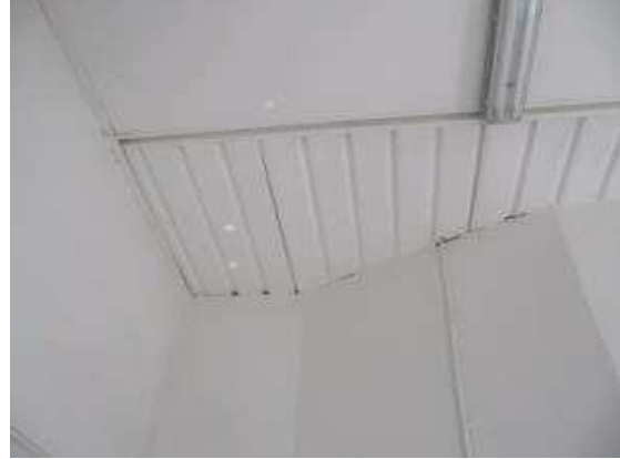
Foto 29: particolare controsoffitto, area bagni, anno 2016
