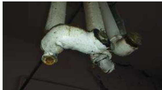
Foto 47: tubazioni presso le cucine, particolare
